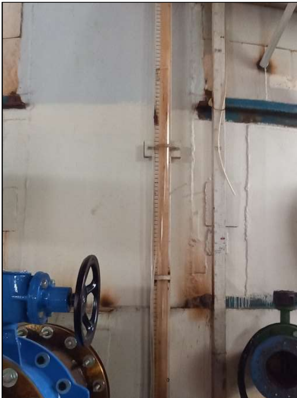
شکل ۱۴- نمایی از مانومتر روی هیدتانک و خط کش مدرج کنار آن، جهت قرائت ارتفاع آب داخل مخزن
